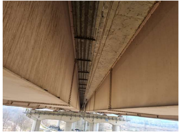
바닥관하면 S4 내측 캔틸레버 상태현황
